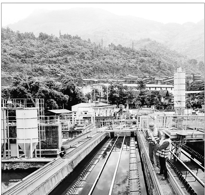
Trạm xử lý nước tại mỏ than.
