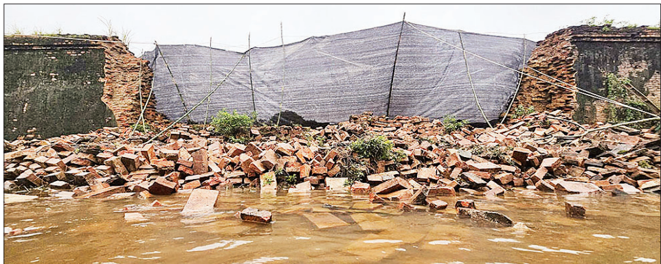
Tường thành kinh thành Huế bị đổ sập sau trận mưa lũ.
