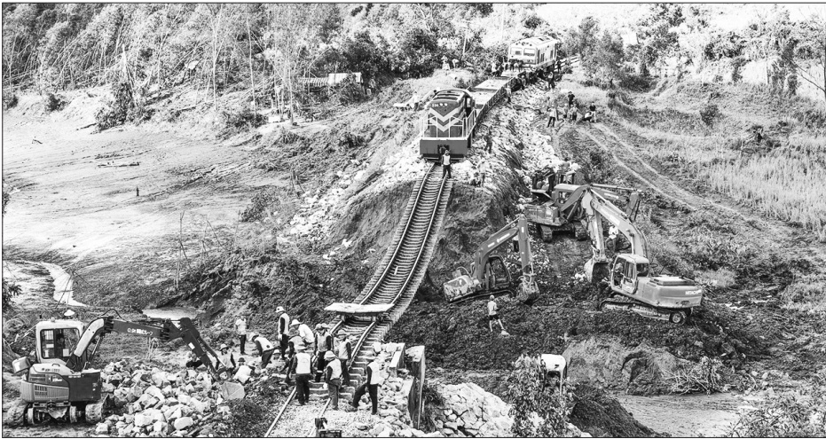
Ngành đường sắt tập trung nhân lực khắc phục vị trí sạt lở trôi nền đường trên địa bàn Đắk Lắk khiến ray đường sắt treo lơ lửng trên không.
