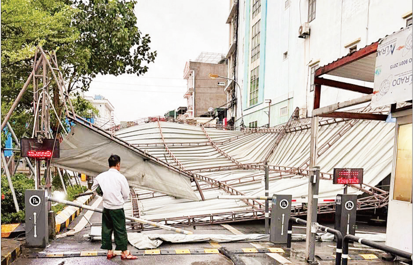
Một góc mái che tại Bệnh viện Phụ sản Thái Bình sập đổ hoàn toàn. (Ảnh MAI TÚ)
