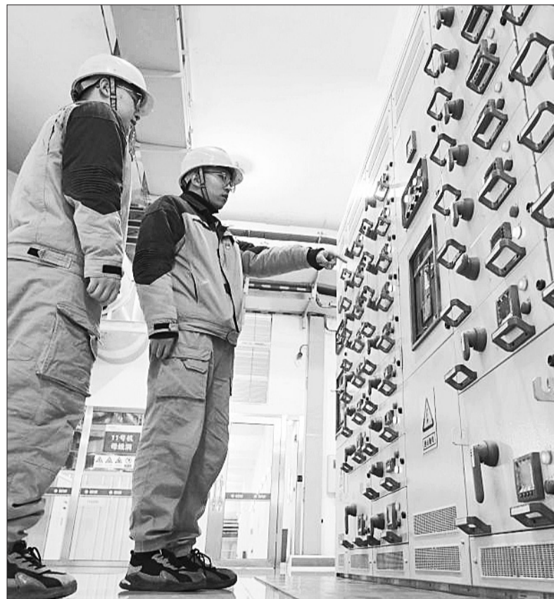
Công nhân vận hành nhà máy thủy điện tích năng ở Trung Quốc. (Ảnh TÂN HOA XÃ)
