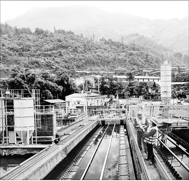
Trạm xử lý nước tại mỏ than.
